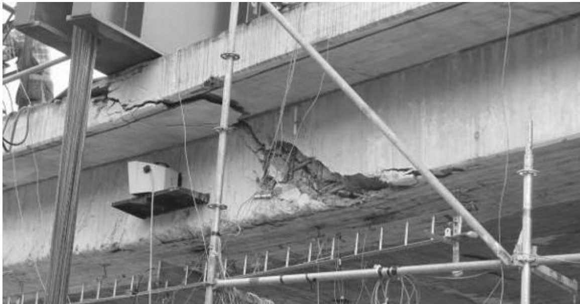
1.1-rasm - Sinov paytida ko'prikning oldindan zo'riqtirilgan temir-beton yakuniy yo'q qilinishi [138]
